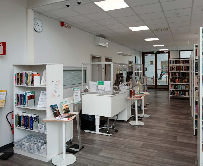
Tohmajärven kirjastotila on kuuma isojen ikkunoiden takia, asiakaspalvelupisteen taakse on asennettu jälkeinpäin viilentävä ilmalämpöpumppu.
